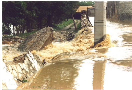
Vidange du casier par la brèche de la route de Remoulins, le 10 septembre dans la matinée (photo mairie de Comps)
