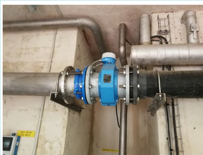
Débitmètre électromagnétique - mesure des eaux brutes à traiter (point réglementaire A3)
