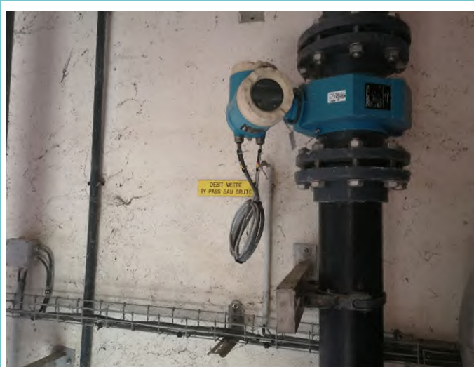
Débitmètre électromagnétique - mesure des eaux déversées en tête de station (point réglementaire A2)
