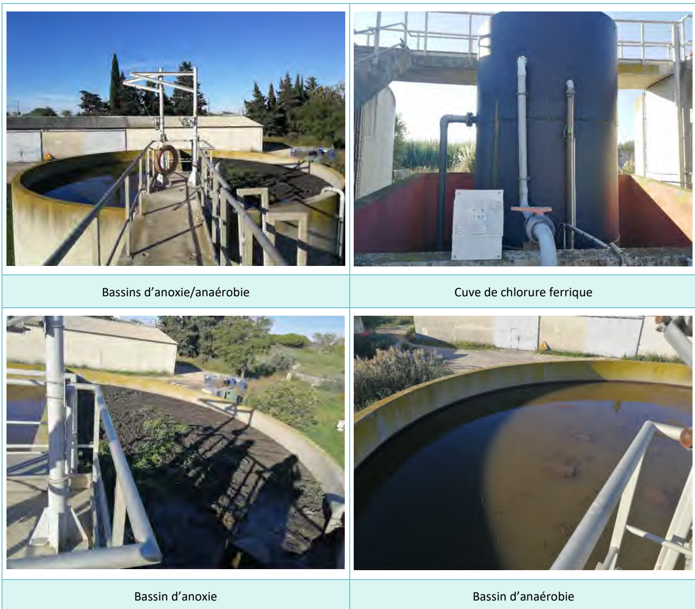
Figure 7 : Planche photographique des bassins d'anoxie/anaérobie
