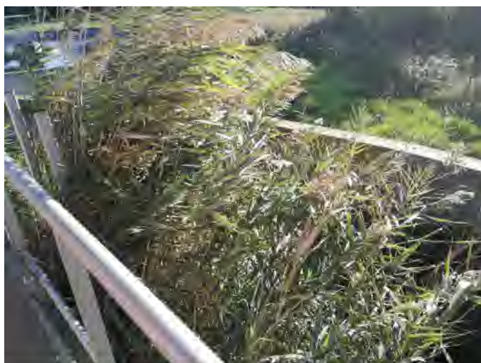
Présence de végétation au niveau de la turbine en panne
