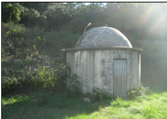
Figure 10 – Edifice de la source Est de la Route de REDESSAN (à l'arrière plan la clôture grillagée partielle de protection du Périmètre de Protection Immédiate)
