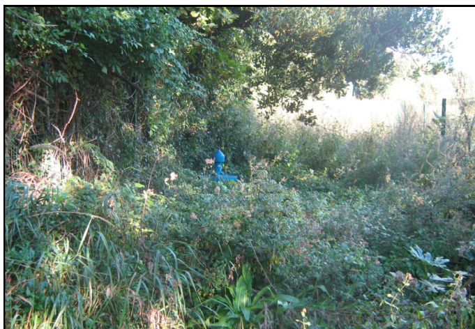
Figure 11 – Vue de l’intérieur du Périmètre de Protection Immédiate montrant l’un des capots Foug de protection des galeries de captage et les clôtures grillagées de protection du PPI
