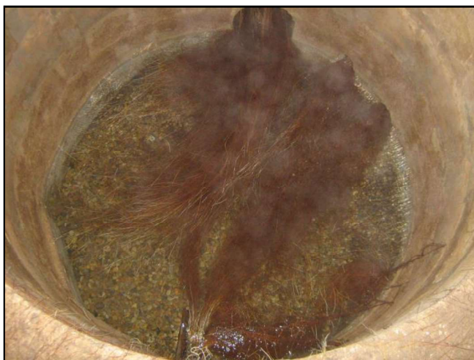
Figure 12 – Intérieur de la source Est de la Route de REDESSAN montrant l'arrivée d'une ou plusieurs galeries drainantes
